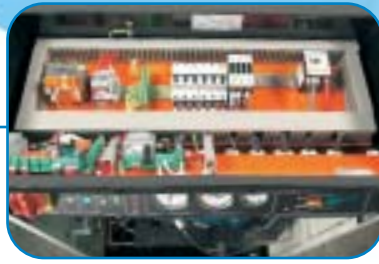
Quadro elettrico Control panel
